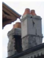
Rambervillers – Fissuration large et écoulement partiel de cheminées suite au séisme du 22 février 2003
