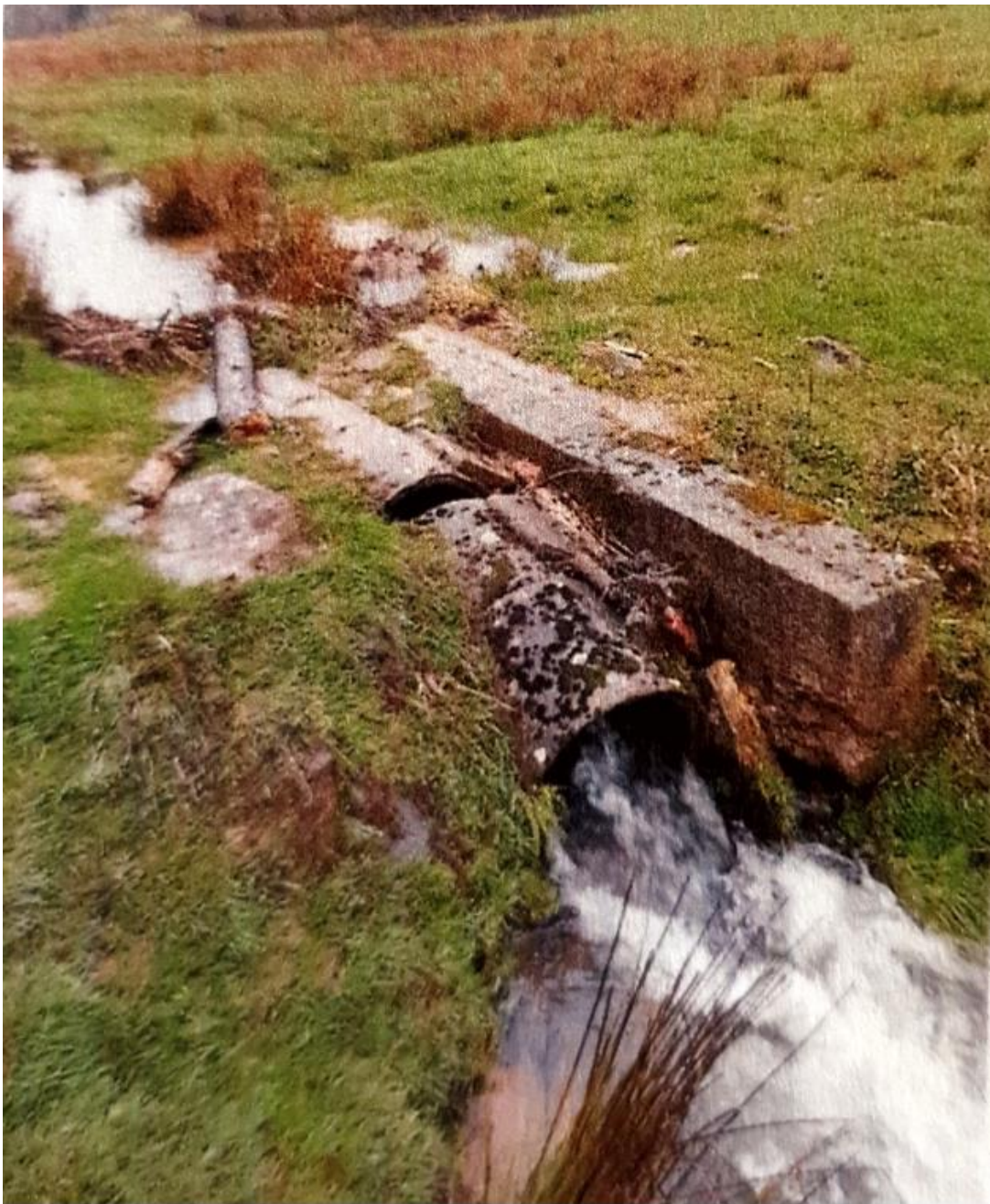
Suppression de buse et passage à gué, pose de clôtures et aménagement d'un abreuveau
