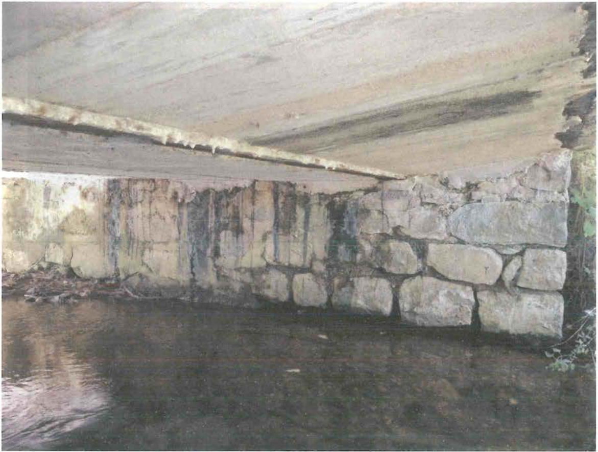
Pont POUTRELLES ENROBEES - Appuis à réparer
