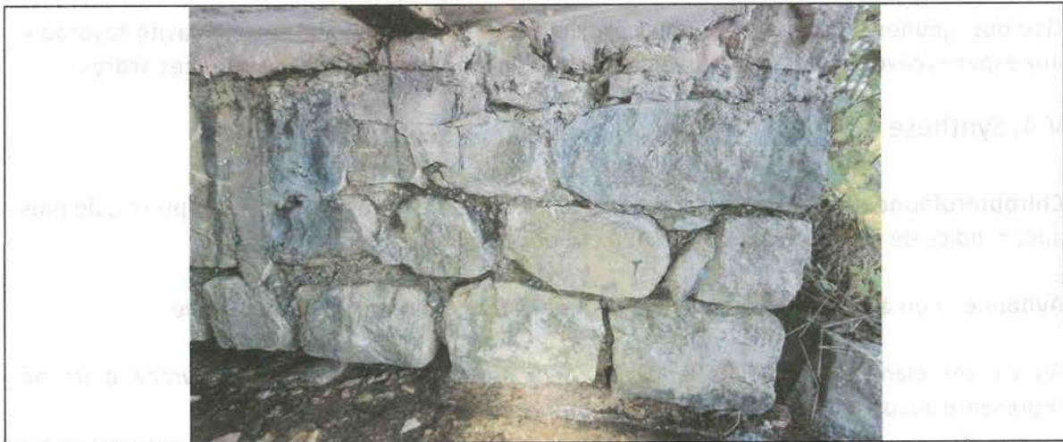
Zoom sur les disjointements de la culée nord
