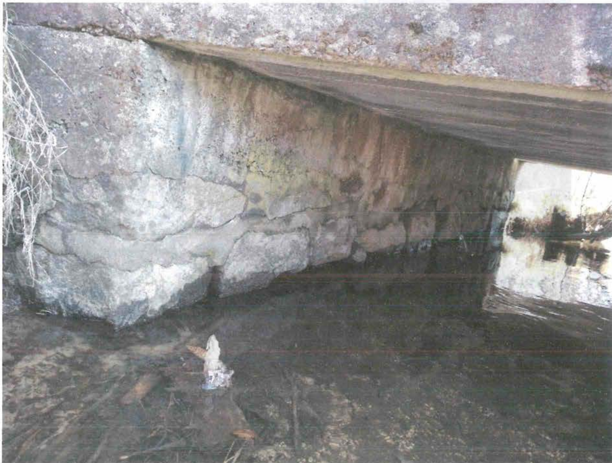
Pont DALLE - Appuis a réparer
